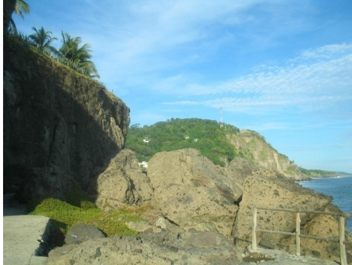
Fig. 1 Desprendimientos de bloques en playas del departamento de La Libertad.
