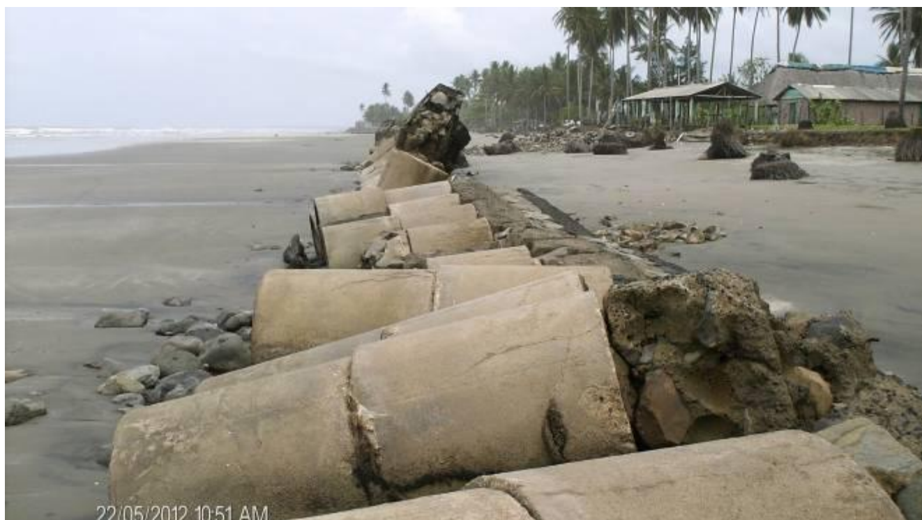
Figura 44: Puede apreciarse la existencia de grandes escarpes en la parte posterior del muro derribado por las olas
