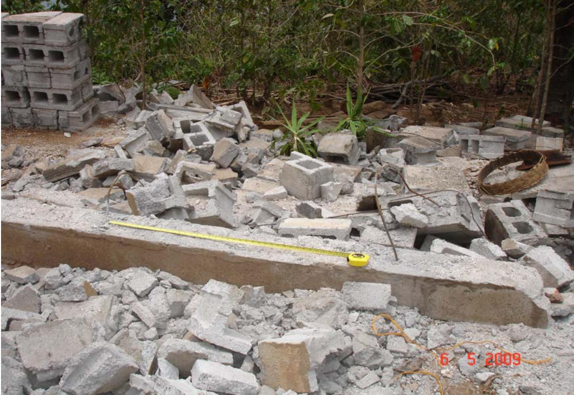
Figura 8. Destrucción en vivienda por sismo del 3 de mayo de 2009 a las 11:17 pm en Cuyanausul (municipio de Atiquizaya).
