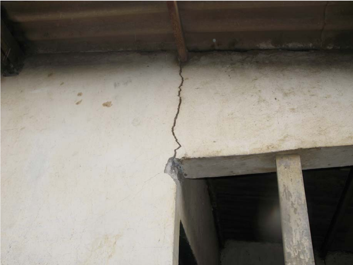
Figura 9. Daño en unión pared-viga. Casa de habitación Cantón Buenos Aires, al norte de Juayúa.
